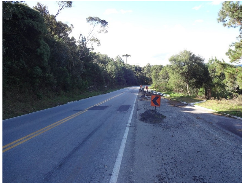
Figura 68: Deslizamento no acostamento - km 106
