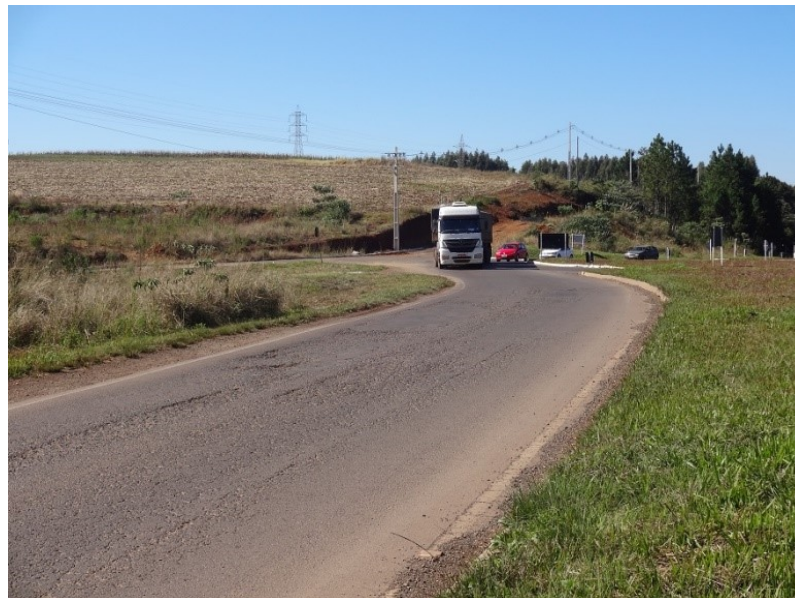
Figura 57: Situação do pavimento no km 406 – Trincamento e buracos no pavimento
