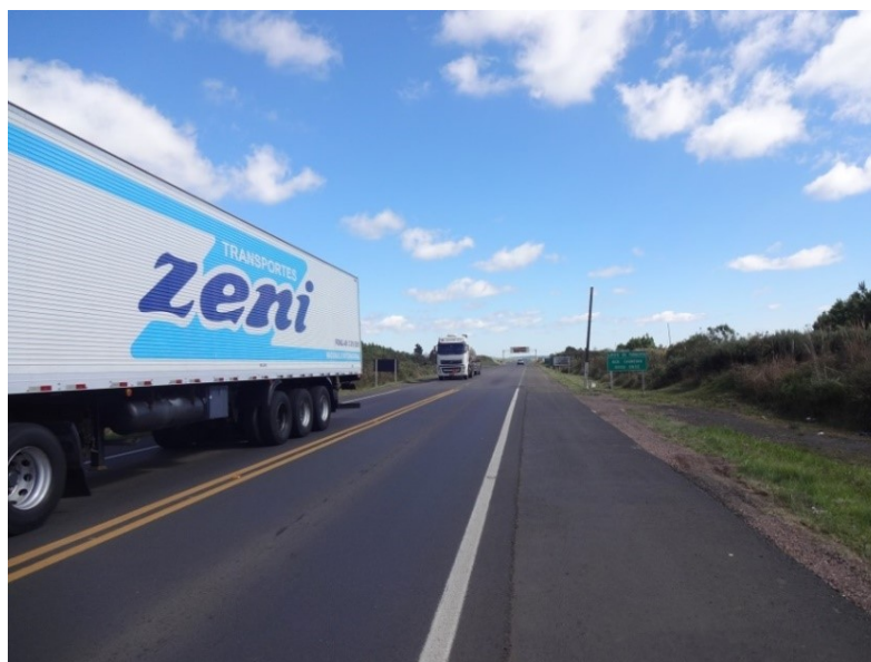
Figura 51: BR-153 - Divisa SC/PR (Água Doce e General Carneiro). Observa-se a diferença da manutenção do pavimento no PR (1º plano) e em SC (2º plano)
