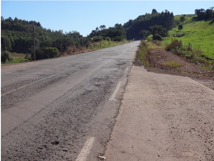
Figura 6: Situação de trincamento do pavimento no km 113,8
