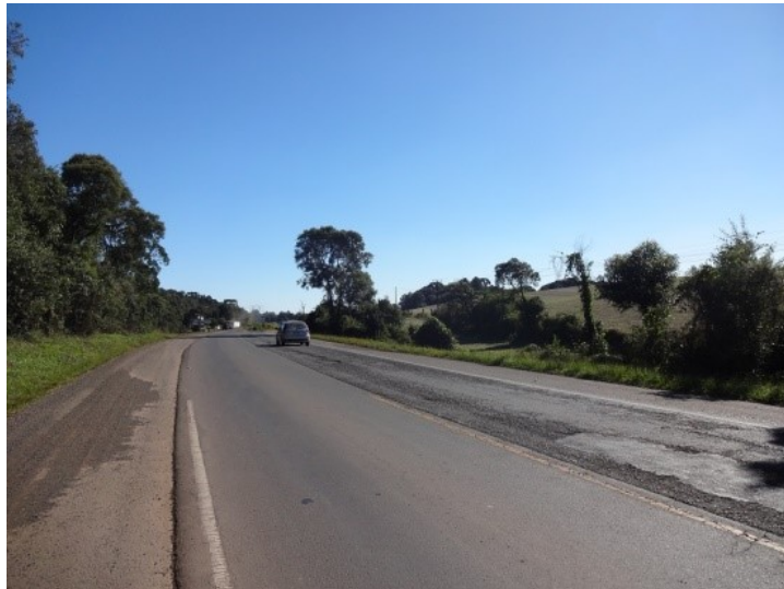
Figura 60: Km 290 da BR-470 (Desagregação e trilha de roda no pavimento)
