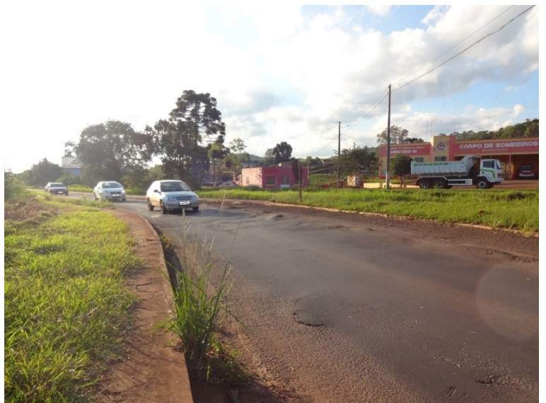
Figura 33: BR-282/SC- Situação do pavimento em frente ao Corpo de Bombeiros em Pinhalzinho
