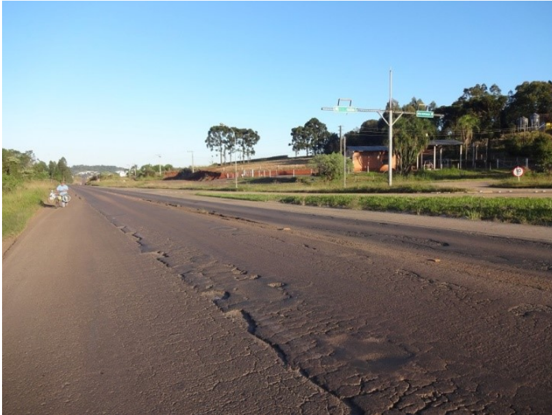
Figura 40: km 606,0 da BR-282/SC – Trincamento e desagregação do pavimento
