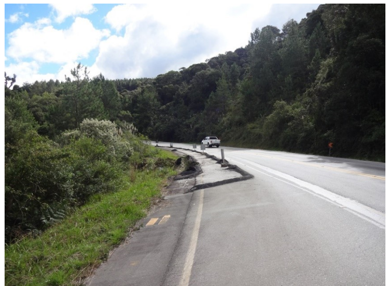
Figura 66: Km 83- Deslizamento no acostamento
