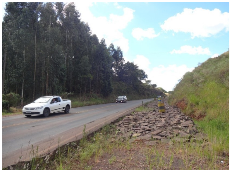
Figura 8: Terceira faixa inacabada no km 95,7
