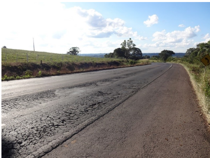
Figura 46: BR-158/SC, no km 101,3- Situação do pavimento (desagregação e trincamento)
