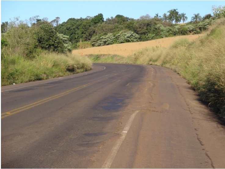
Figura 34: Trilha de roda e afundamento no km 582 da BR-282/SC
