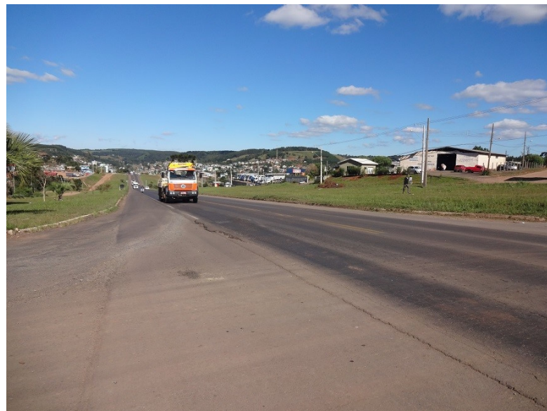
Figura 12: Situação do pavimento no km 458,5 da BR-282/SC
