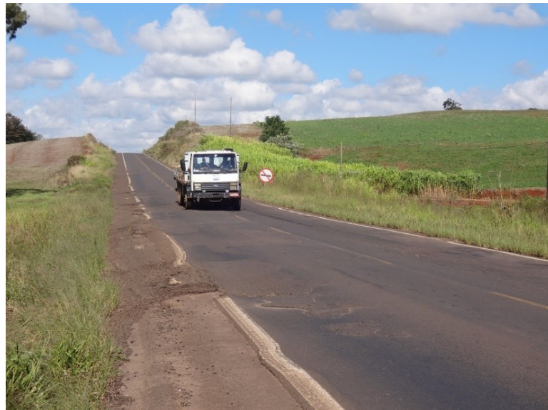
Figura 7: Afundamento e recalque do pavimento no km 117,0
