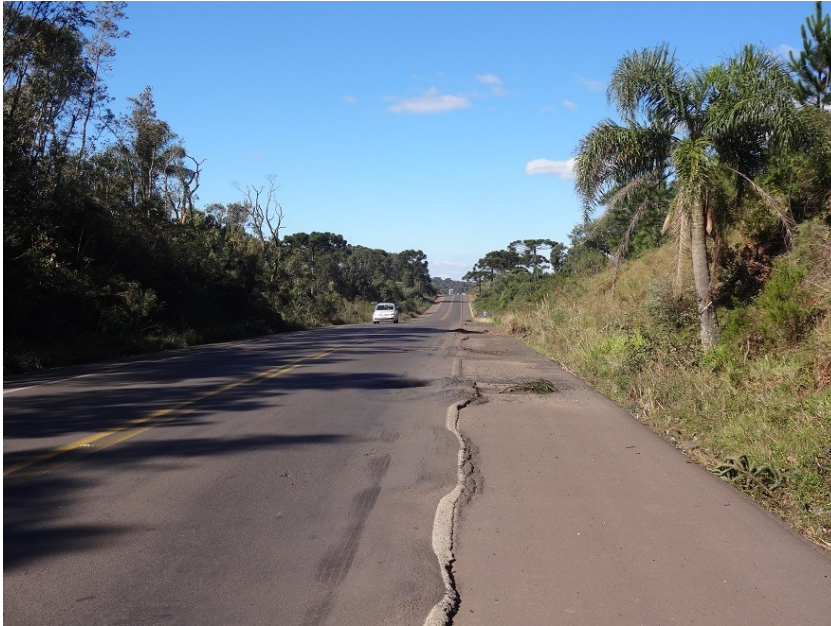
Figura 13: Afundamentos e recalques da pista de rolamento no Km 466,0 da BR-282/SC
