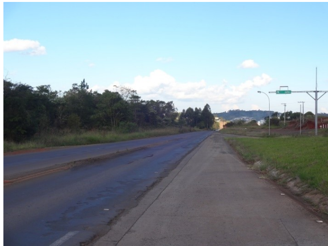
Figura 44: Situação da pista no km 607,6 da BR-282/SC. Afundamentos e recalques
