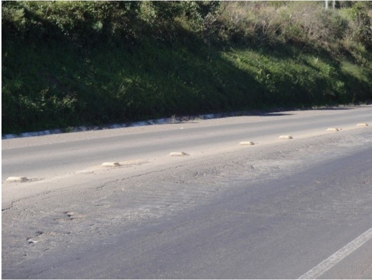
Figura 62: Situação do pavimento no km 300,7 da BR-470 (Buracos, trincamento e afundamentos)
