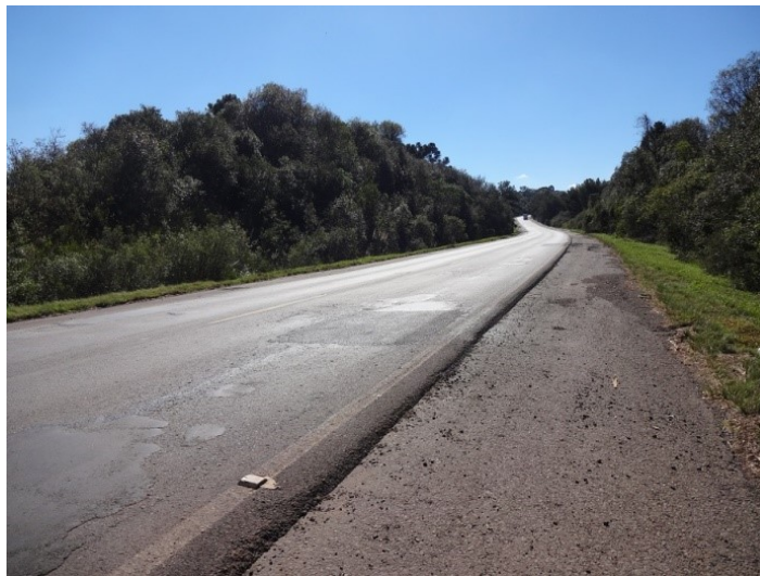
Figura 54: BR-153, situação do pavimento no km 56,5
