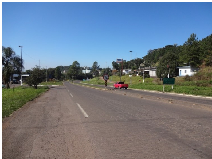
Figura 55: Acesso secundário a Joaçaba- km 384,5- Trincamento e afundamento do pavimento
