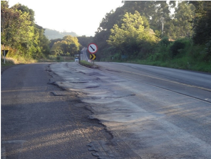
Figura 25: Buracos, afundamentos, recalques, trilha de roda no km 554,0
