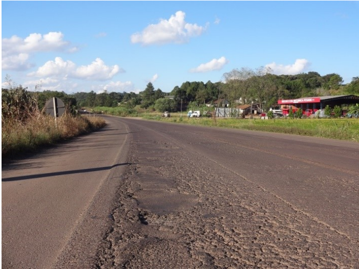
Figura 49: Situação do pavimento - km 108 da BR-158 (Buracos, trincamento e deformações)
