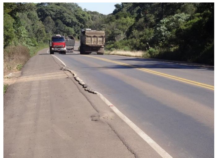
Figura 15: Situação do pavimento no km 475 da BR-282/SC
