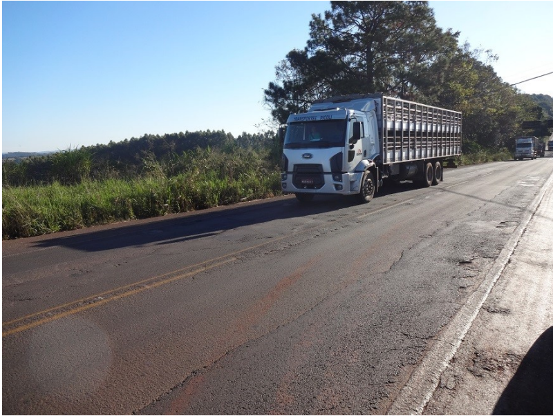
Figura 28: Afundamentos e recalques no Km 568,5 da BR-282/SC
