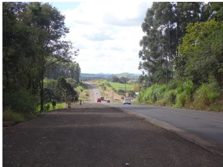
Figura 10: Trecho com a base pronta e abandonado no km 79,5
