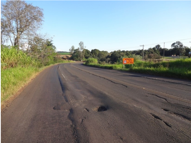
Figura 37: Buracos, afundamentos, recalques na BR-282/SC - km 583,2
