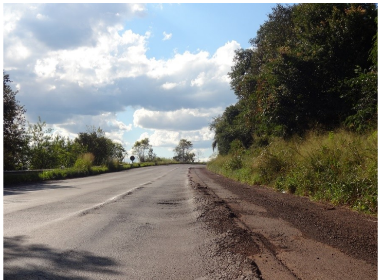
Figura 45: Afundamentos, recalques e desagregação do pavimento no km 626,0
