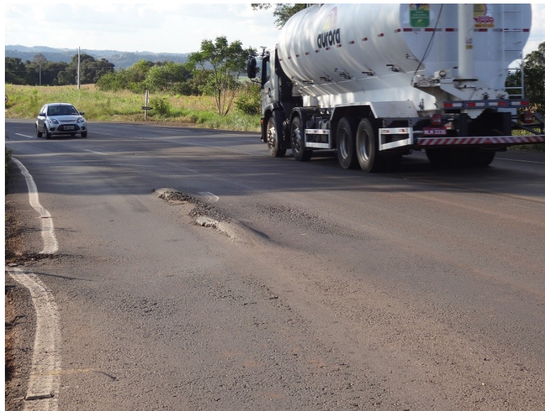
Figura 35: BR-282/SC- Afundamento e recalque no km 582,7
