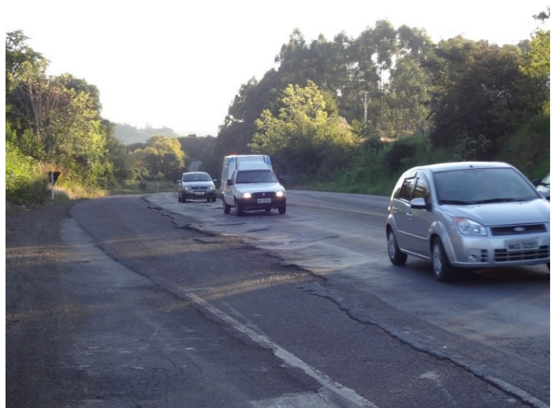
Figura 27- Situação do pavimento no km 554,0
