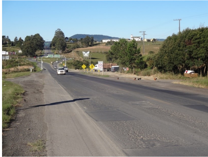
Figura 70: Situação do pavimento- km 207 (Trincamento e trilha de roda)
