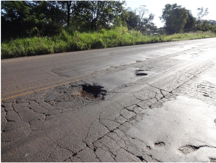
Figura 22: Km 546- Buracos, afundamentos, recalques no pavimento, num segmento de aproximadamente 2,5 km da BR-282/SC
