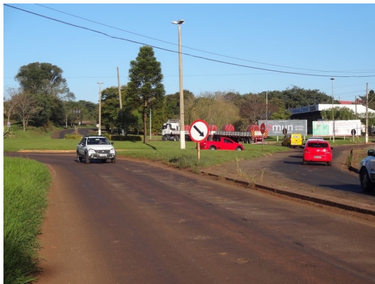
Figura 32: Buracos e afundamentos no Acesso a Pinhalzinho - km 575,0
