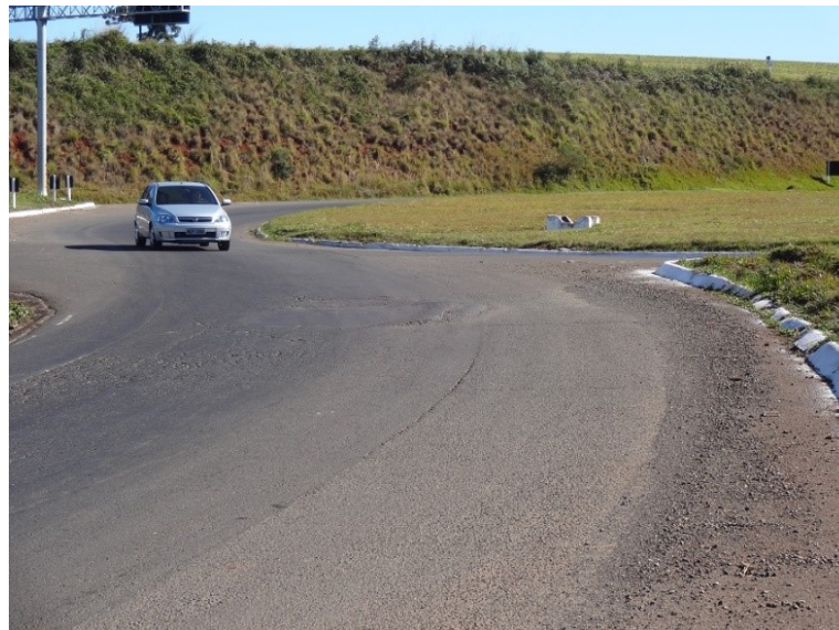
Figura 63: Entroncamento BR-282 com a BR-470 (Desagregação do pavimento)
