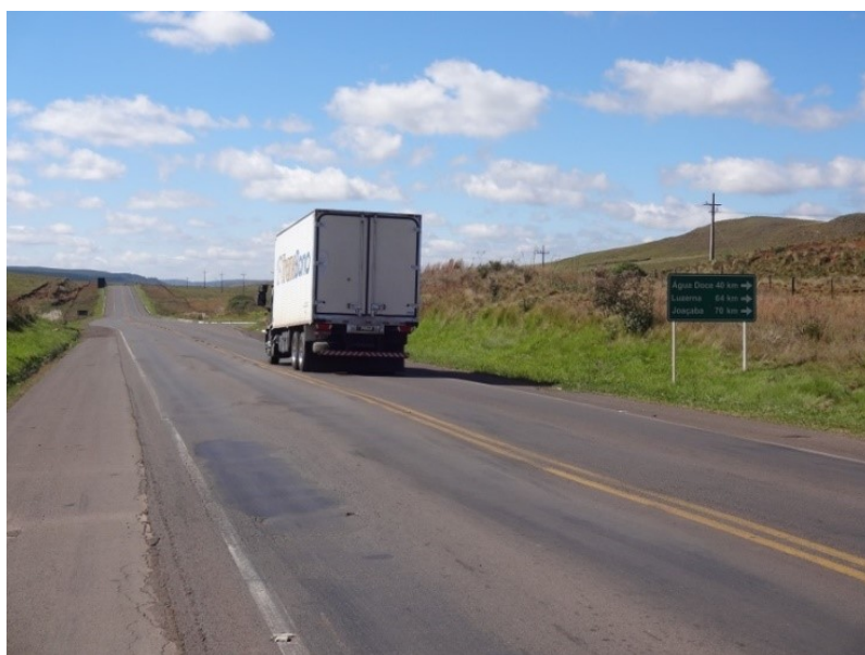
Figura 52: Acesso a Água Doce – Afundamento e recalque do pavimento
