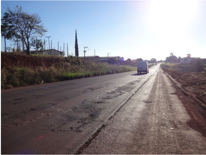
Figura 31: Buracos e trilhas no pavimento da BR-282/SC- km 574
