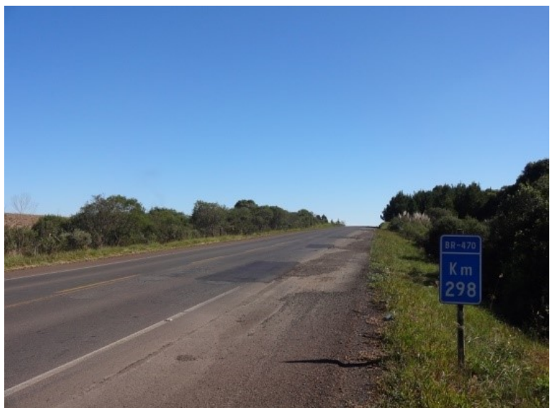
Figura 61: BR-470, km 298- Situação do pavimento
