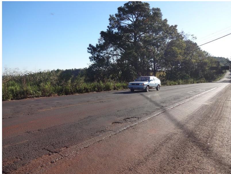
Figura 29: Situação do pavimento no km 569,0
