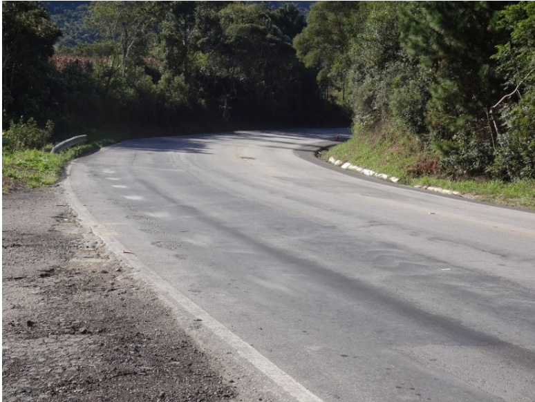
Figura 67: km 105 (Buracos e trilha de roda)
