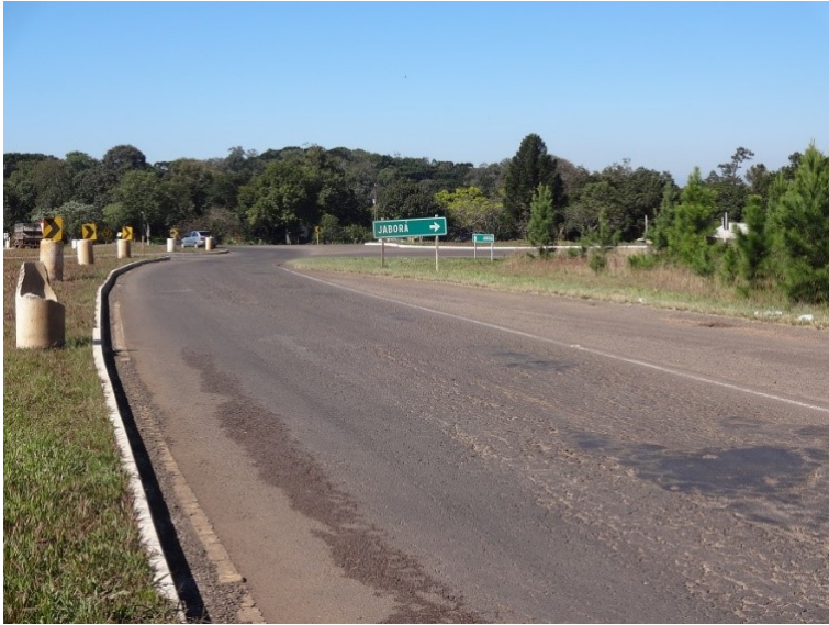
Figura 56: Acesso a Jaborá - km. 403 – Buraco e desagregação do pavimento
