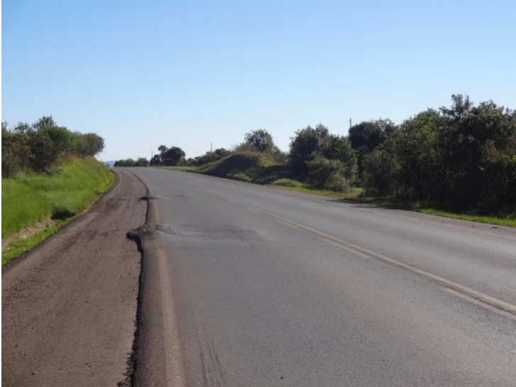
Figura 59: BR-470, km 265- Situação do pavimento (Afundamento e recalque)
