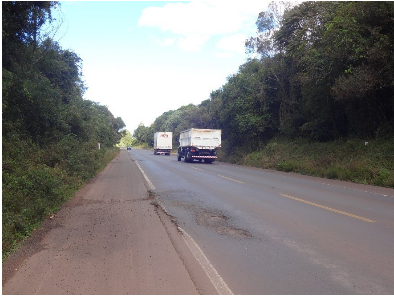
Figura 16: Buracos, afundamentos e recalques do pavimento km 477,0 da BR-282/SC
