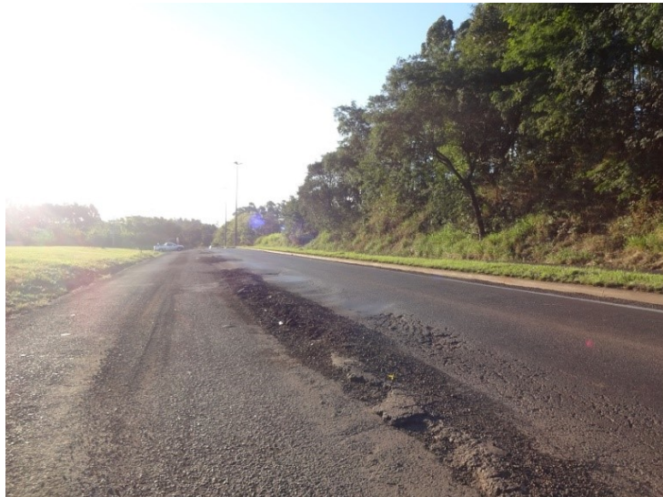
Figura 26: Trilha de roda, trincamento e desagregação no pavimento no km 554,8
