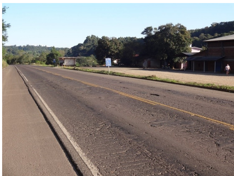
Figura 48: BR-158/SC- km 106,0- Trincamento, afundamento e recalques do pavimento
