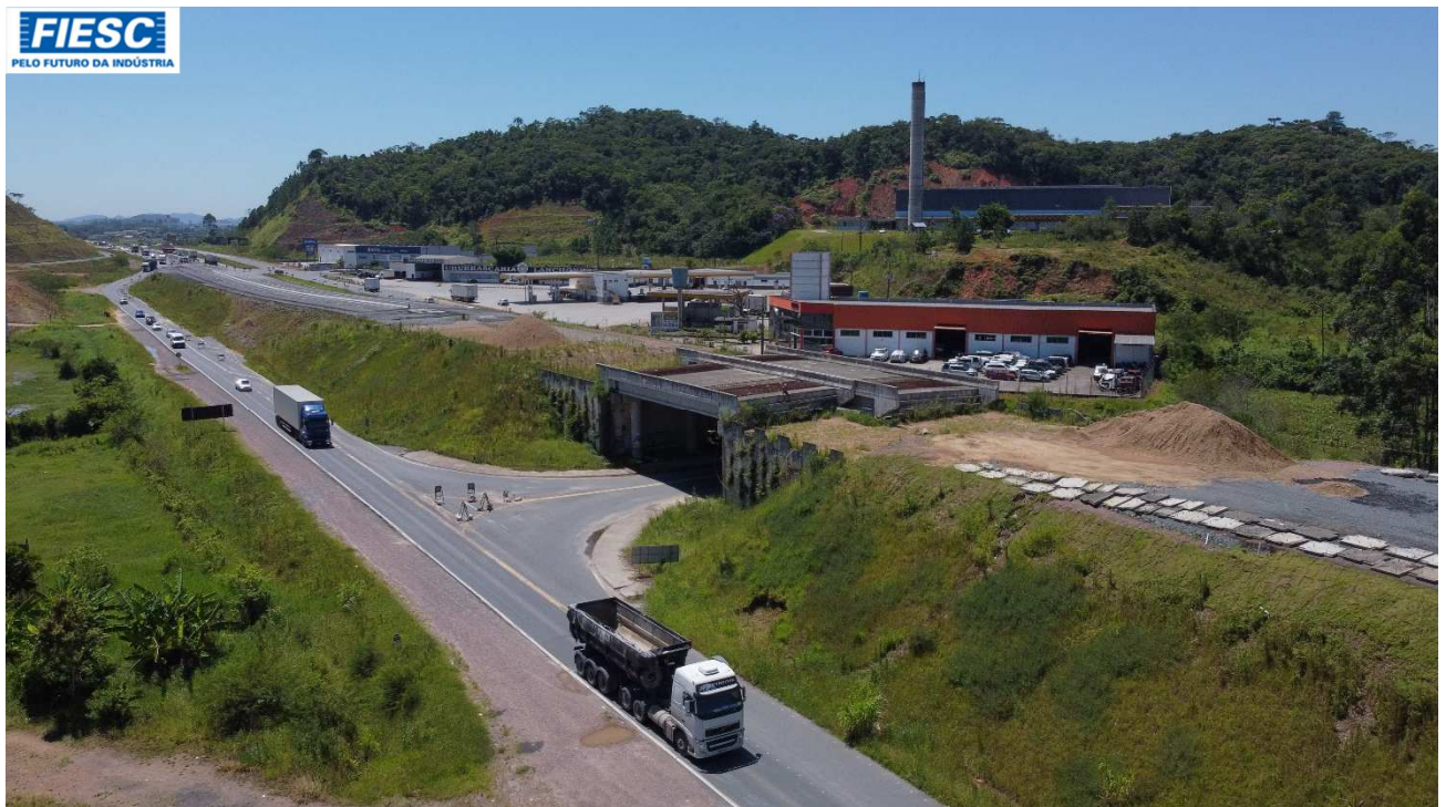
15: VIADUTO EM EXECUÇÃO NO KM 36,2 - ESTADO DE ABANDONO
