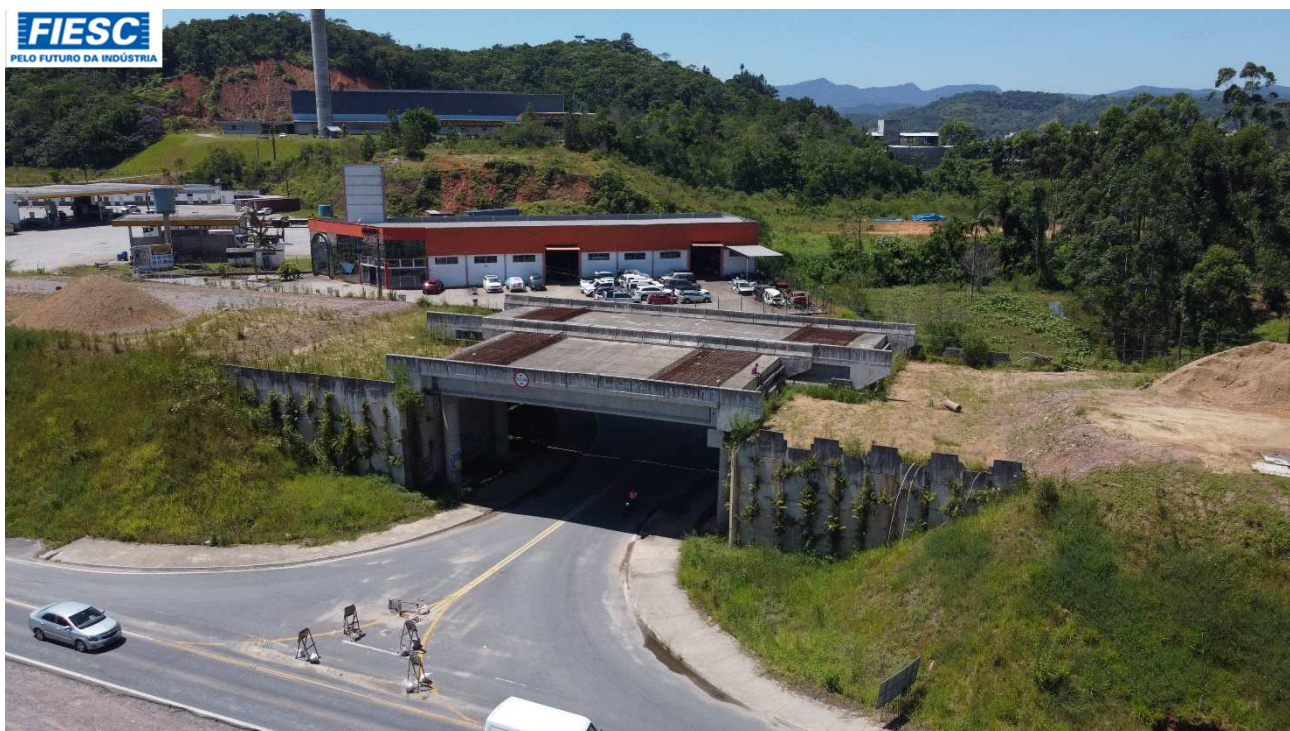
16: OUTRA VISTA DO VIADUTO KM 36,2 - ESTADO DE ABANDONO
